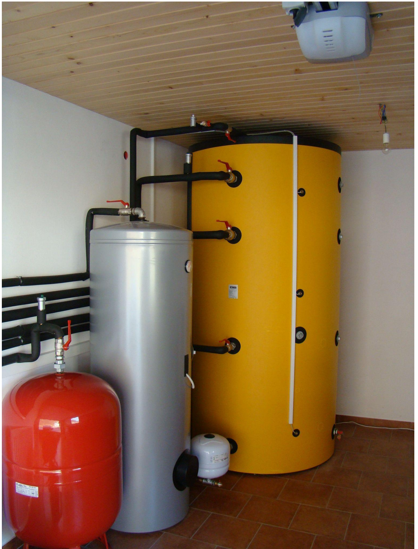
Ekspanzijska posoda, bojler STV 300 l, akumulator ETA SP 1.650 l
